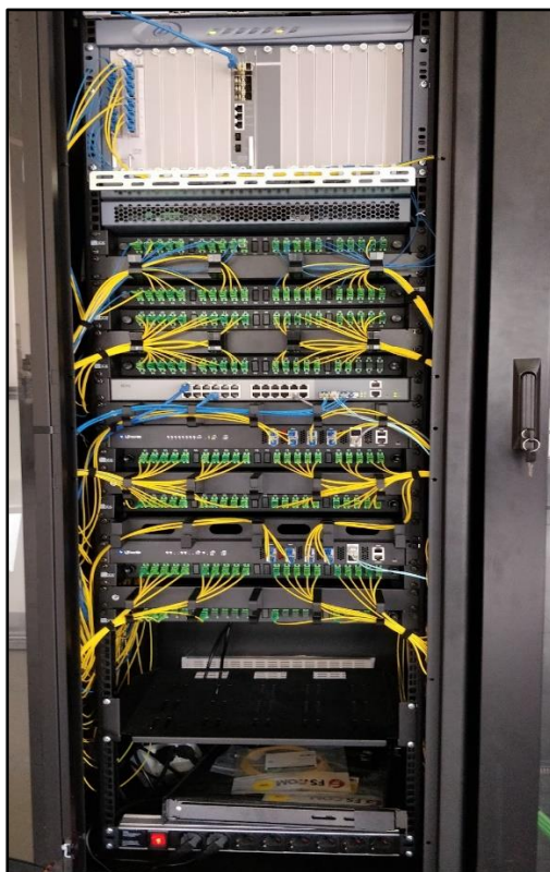
FIG.11 Armadio alimentato con apparati OLT GPON e splitter in sede ACSM Fiera di Primiero (Foto Tecnodata)
